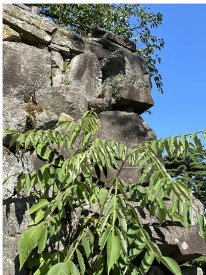
本丸北側の石垣の変状
