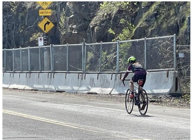
写真10 落石防護柵付きコンクリートバリア
