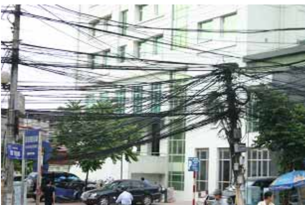
旧市街には電線が多い
