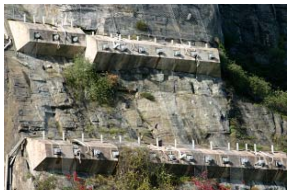
ロックアンカー
