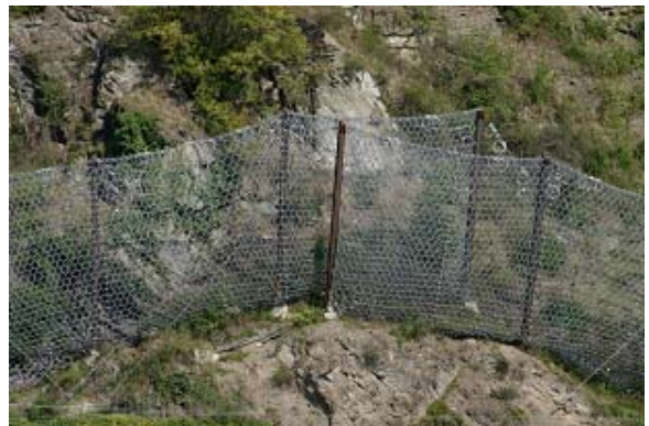
落石対策として設置されたリングネット工法
