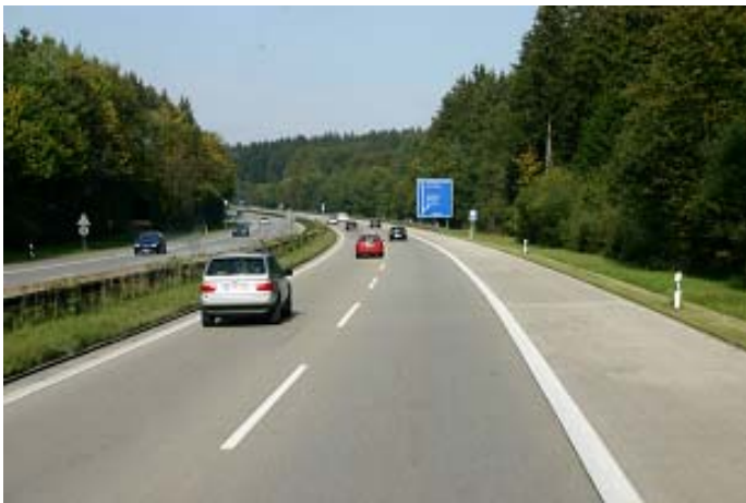
右側の路側部にガードレールがない
