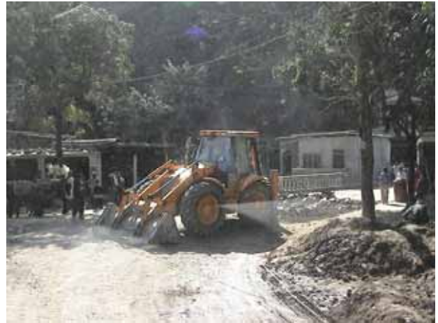
シッダ - ルタ・ハイウェイでの舗装工事
