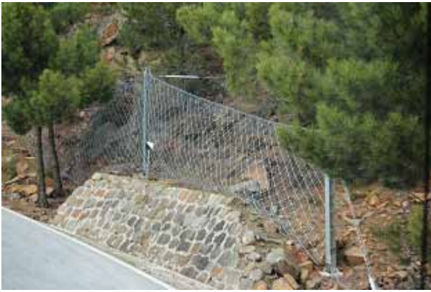
落石防護柵。金網の編み方が日本のものとは異なっている。
