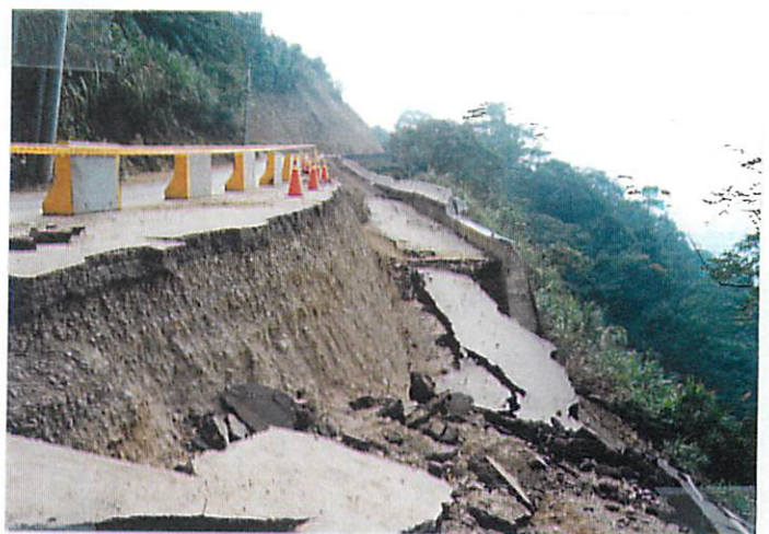
写真 66 草嶺登山道の擁壁の倒壊
