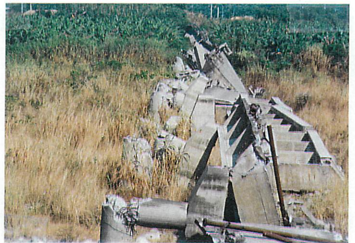
写真 49 脚注が折れて倒壊した平林橋
