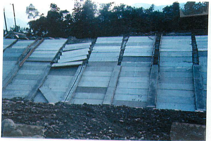
写真 65 施工中に被災した護岸工
