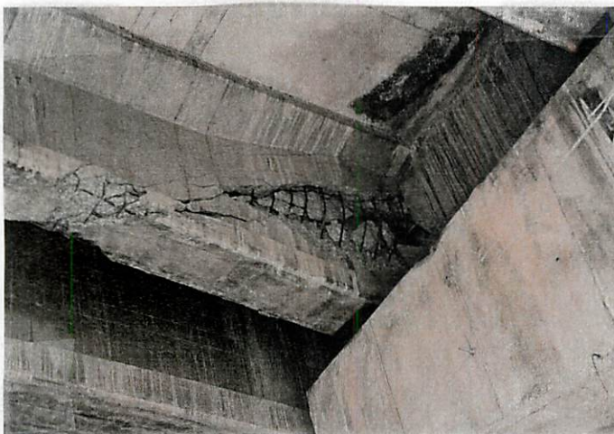
写真 20 上流側へ大きな水平力が作用し、上流拡幅橋の下流側外桁の端部が破損している
