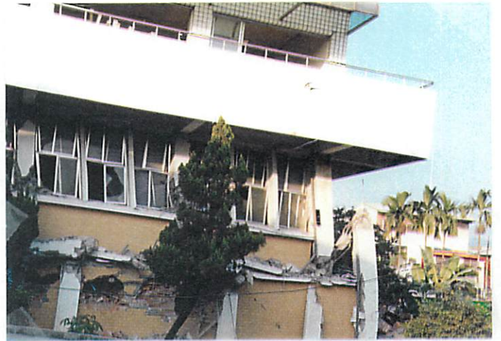
写真 56 1階が押し潰された中寮郷公所
