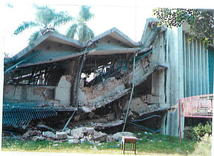
写真 41 倒壊した光復国中学校の北館
