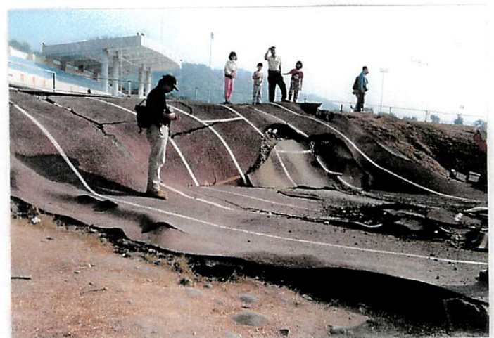
写真 34 陸上競技場のトラックの北側の段差
