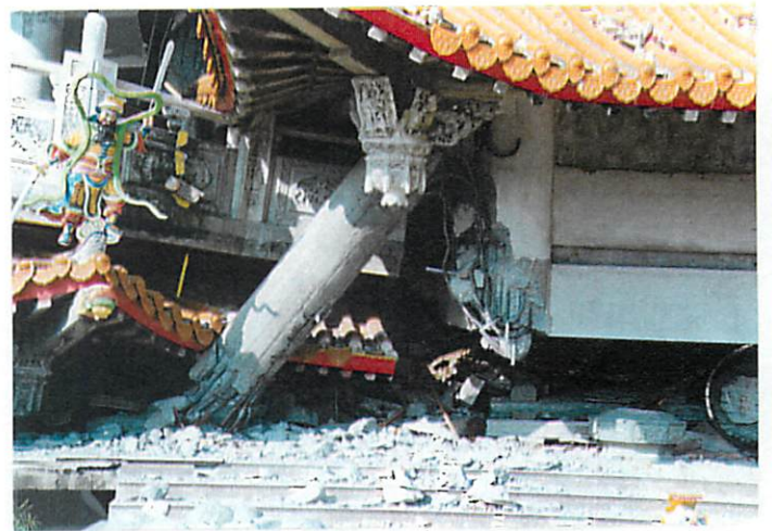
写真 53 武昌宮の柱の破壊状況
