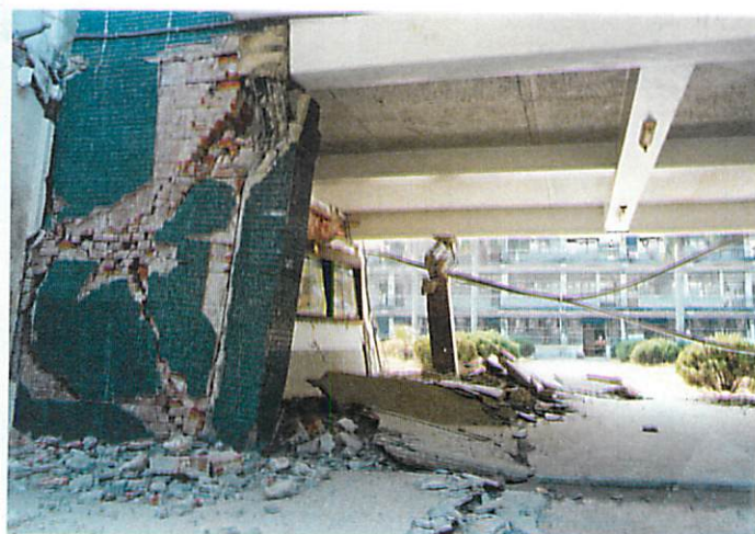
写真 44 光復国中学校北館ピロティの柱の破壊
