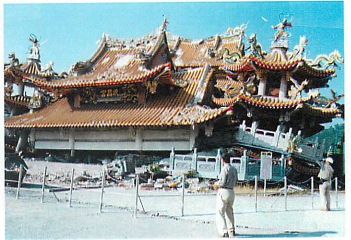
写真 52 一階が完全に押し潰された集集の武昌宮
