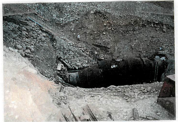
写真3 断層の移動で鉛直および水平方向に大きく変位し、破断された石岡堰配水管
