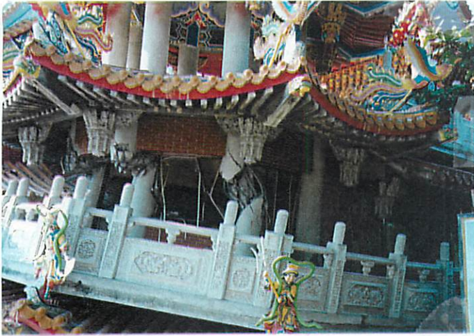
写真 55 武昌宮の柱の破壊状況
