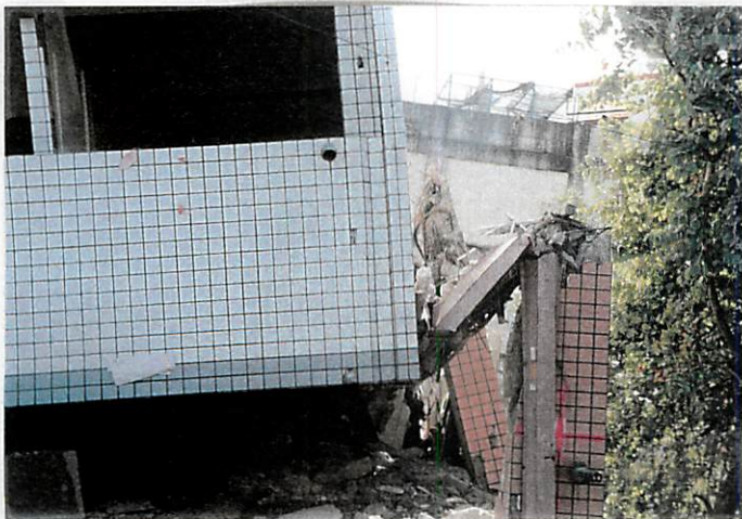
写真 25 マンションの柱の破壊状況
