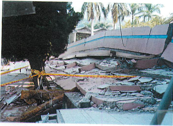
写真 46 北館と南館を連絡する通路の崩壊
