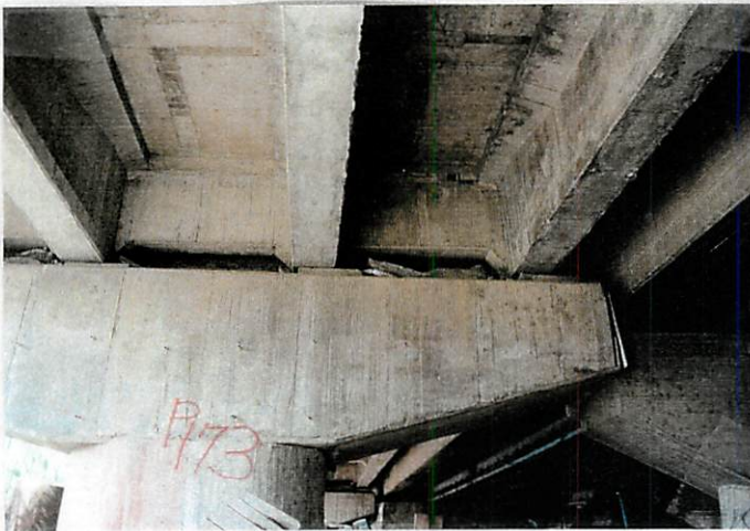
写真 19 上部工全体的に 10cm 程上流(写真の左)側に移動している。
