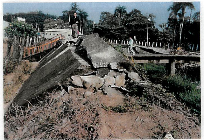
写真 31 乾溪支川の護岸の崩壊
