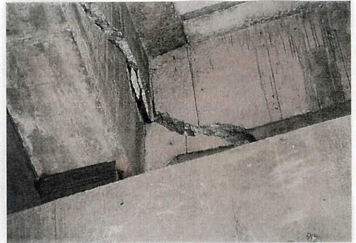
写真 21 上流拡幅橋の下流側外桁の端部及び端横桁がせん断破壊している
