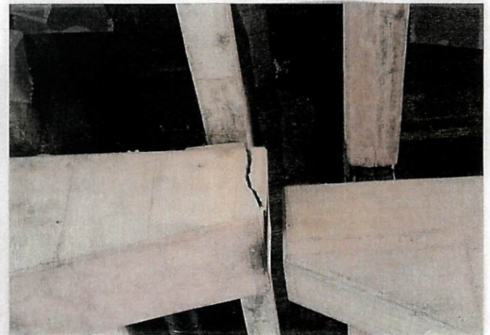
写真 22 下流側の拡幅橋梁の梁端部が上流方向へせん断破壊している。
