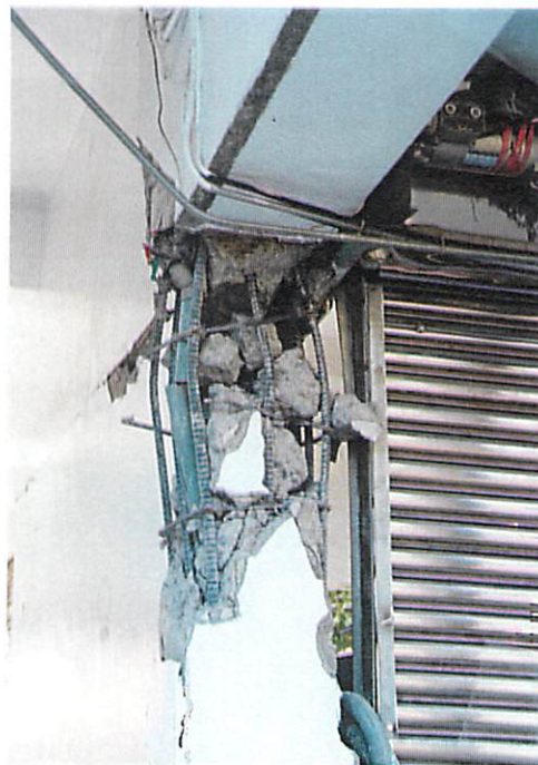
写真 43 光復国中学校北館の柱の破壊
