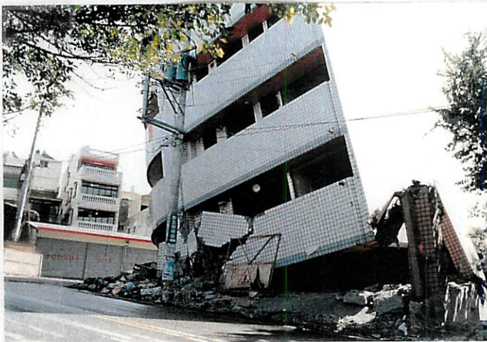
写真 24 1階が押し潰されたマンション
