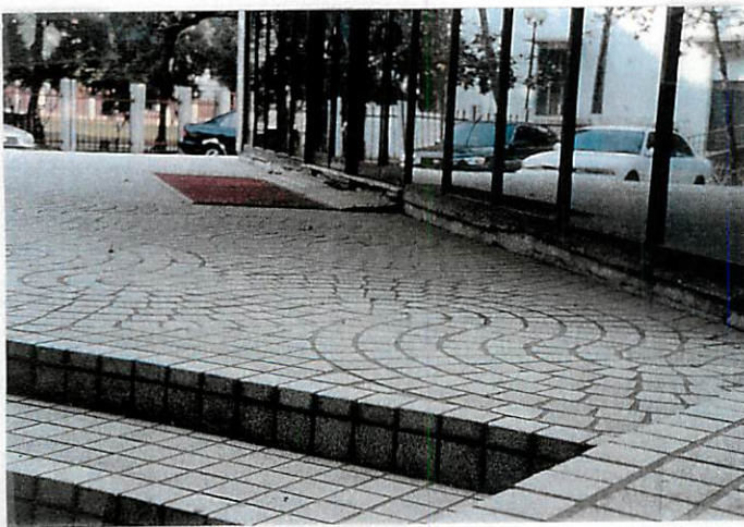
写真 30 図書資料館周辺の地盤沈下
