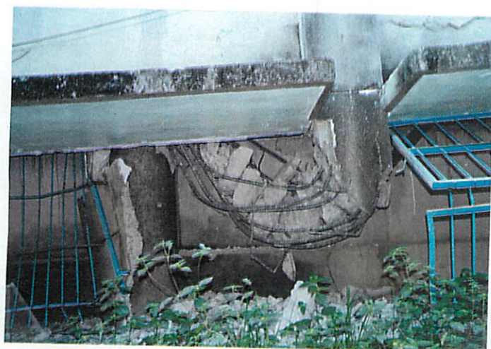
写真 42 光復国中学校北館の破壊状況
