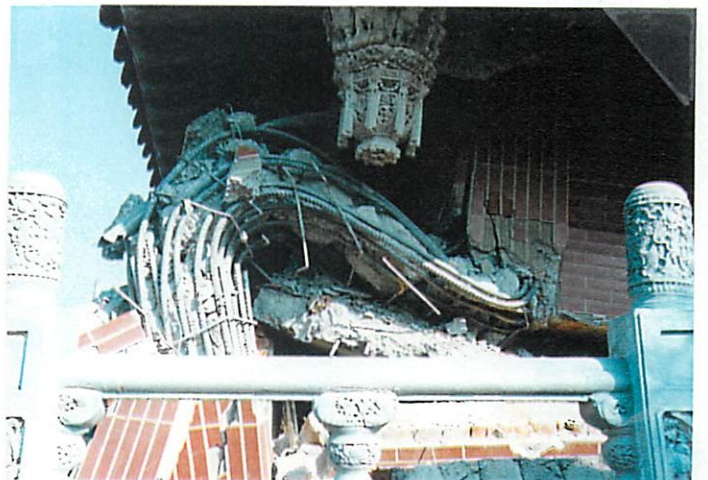
写真 54 武昌宮の柱の破壊状況
