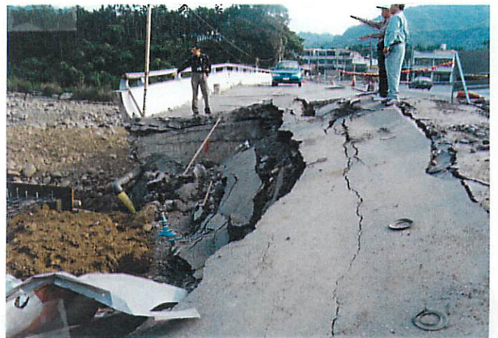
写真 58 道路の隆起で破損した成平橋
