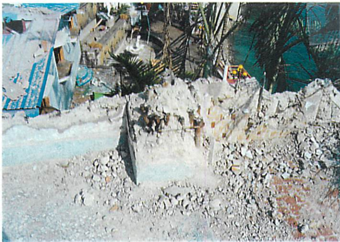
写真 50 日月潭湖畔の10階建ホテルの柱の跡
