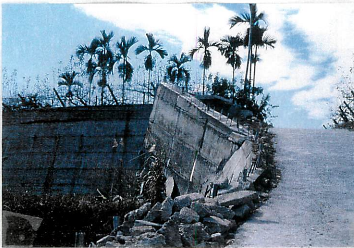
写真 14 東勢鎮石城のもたれ式擁壁の被災
