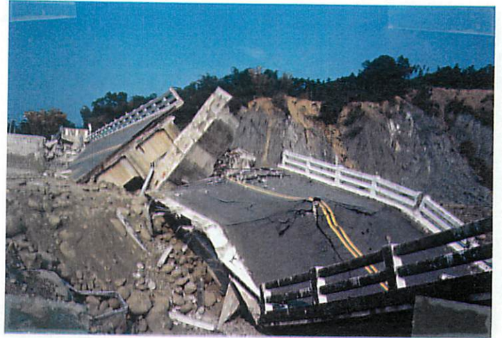
写真 64 倒壊した桶頭橋
