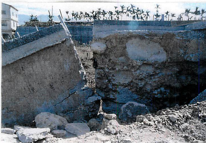
写真 15 東勢鎮石城のもたれ式擁壁の被災
